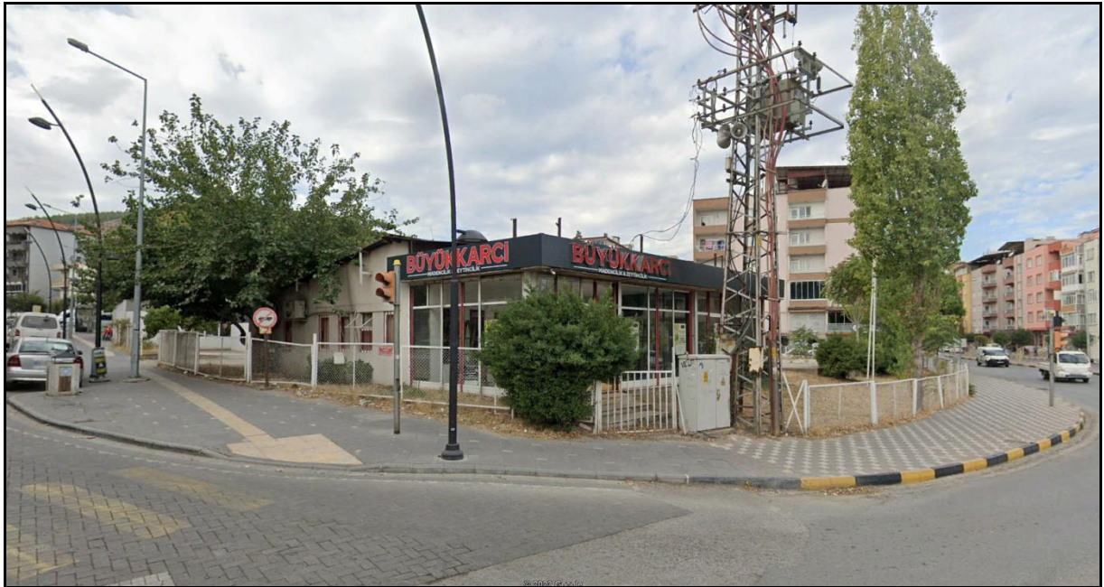
Foto-1: Mevcut Trafo
